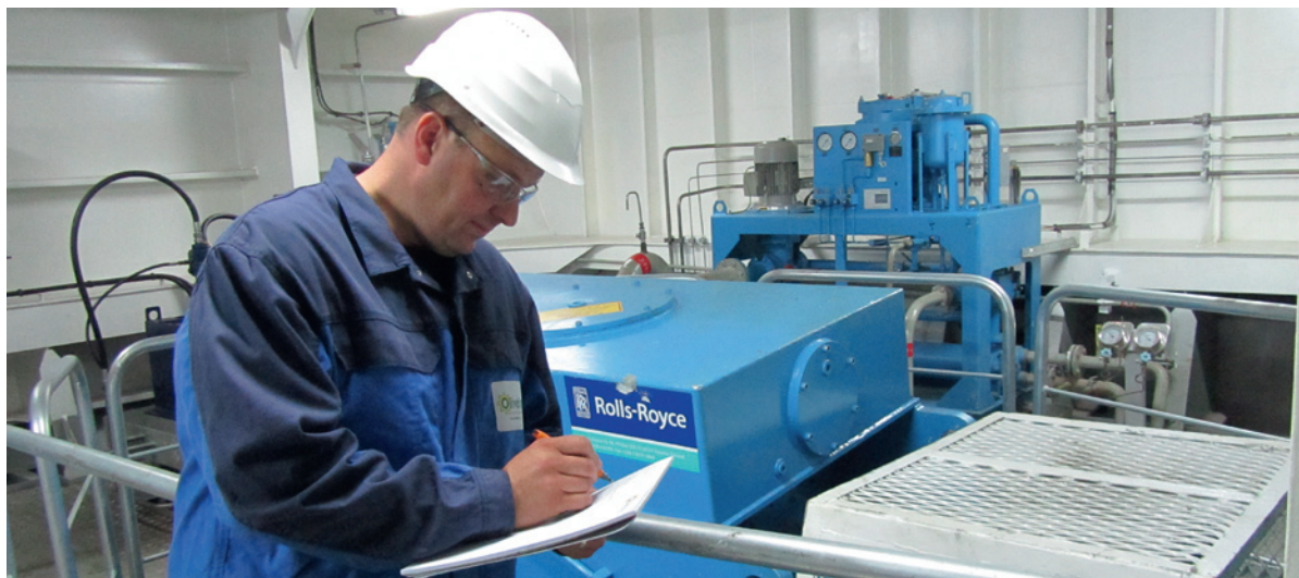
□ Visuele inspecties zijn belangrijk, waarbij de service-engineer onder meer let op zichtbare lekkages en vreemde geluiden (van lagers, tandwielen, aandrijfriemen, stoom- en luchtlekkages, etc.) maar ook op vreemde geuren die op smeermiddel- lekkages (olie op een warm machinedeel bijvoorbeeld) of productlekkage kunnen wijzen.
